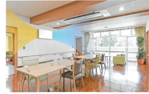
壁面設置で床面スペースを確保
